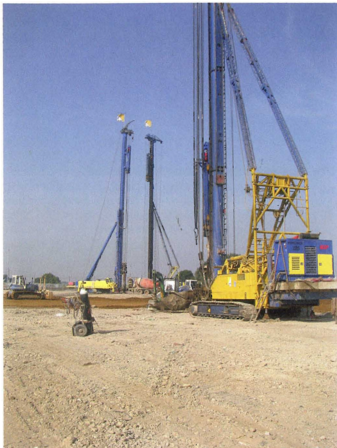
Bild 2. Bei den Gründungsarbeiten werden 7200 Ortbetonrammpfähle in Längen bis zu 24 m bei einem Durchmesser von ca. 40–61 cm gesetzt (Fotos: Kurt Fredrich Spezialtiefbau)
